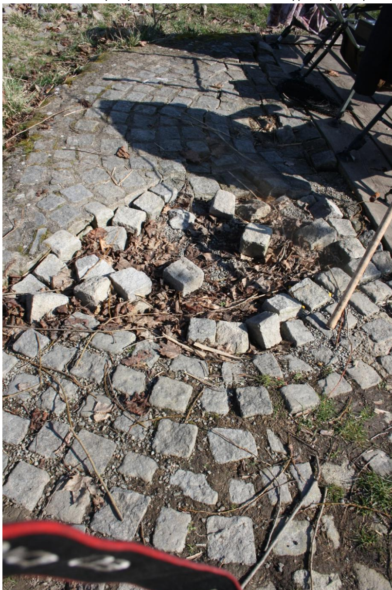
Obr.6 – poškozená přístupová cesta pro tělesně hendikepované
